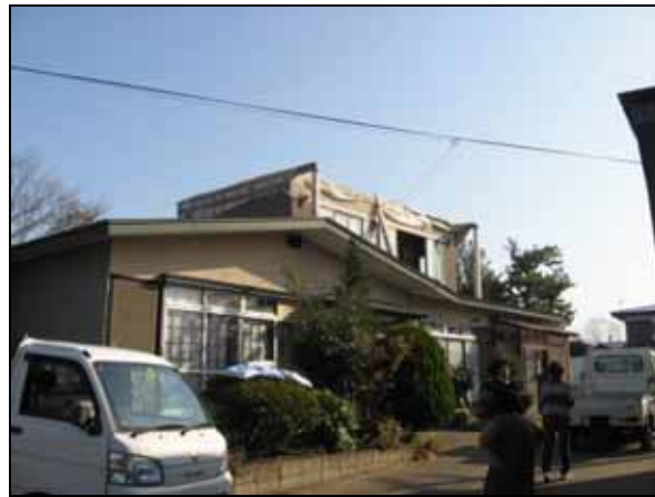
北東方向へ2階部分の屋根が飛ばされた住家 (南西から撮影)
