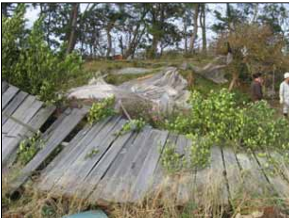
北側に倒壊した板塀とビニールハウス (南から撮影)
