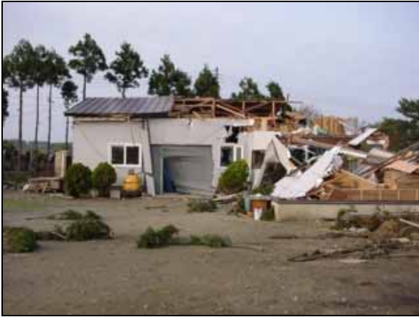
建物の東側が半壊した作業所 (南から撮影)
