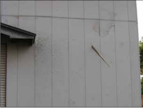
倉庫の東側外壁に刺さった木材 (東から撮影)
