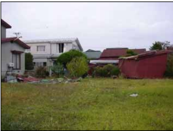
北東方向へ約 9m 飛ばされた物置小屋 (南から撮影)
