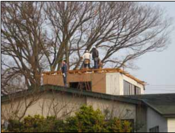
東方向へ2階部分の屋根が飛ばされた住家 (西から撮影)
