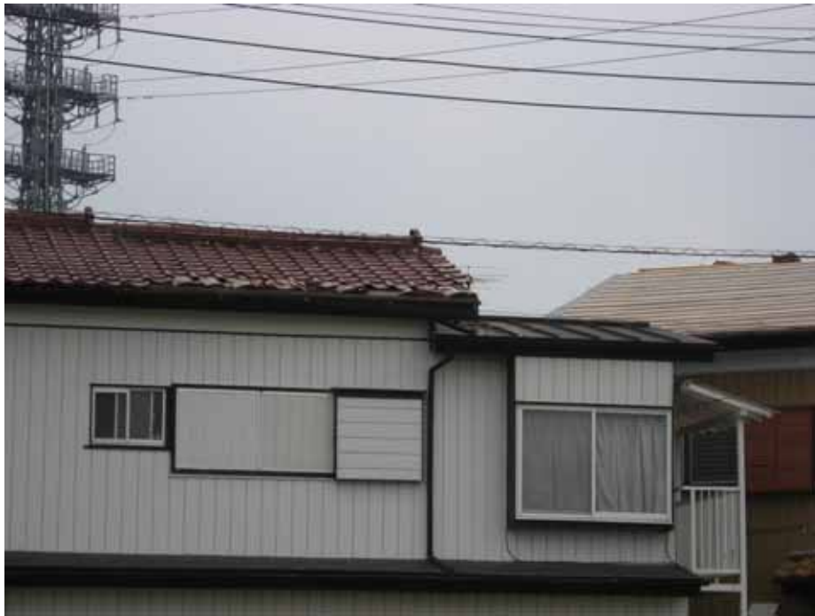
加須市：住家屋根瓦の損壊（北方向から撮影）
