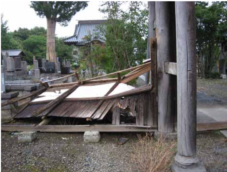
北埼玉郡騎西町：寺院木造塀の損壊（南方向から撮影）
