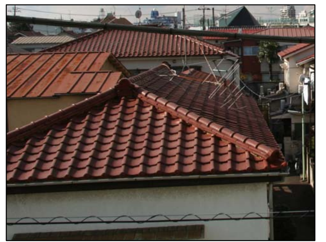
④ テレビアンテナの転倒【東から撮影】
