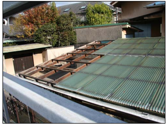
② トタン屋根の剥離【南西から撮影】
