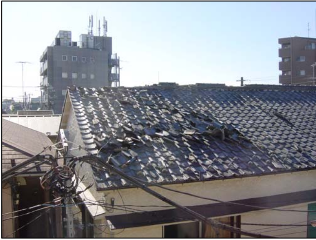
① 住家屋根瓦の剥離【北東から撮影】
