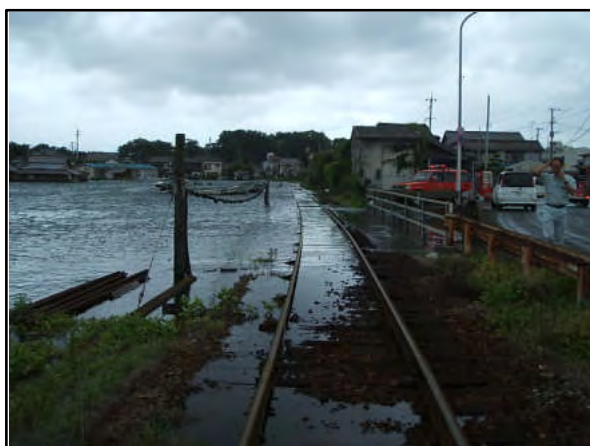
③冠水した島原鉄道の線路（島原市有馬船津町）
