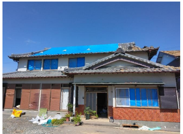
②屋根瓦が破損した住家 （南方向から撮影）
