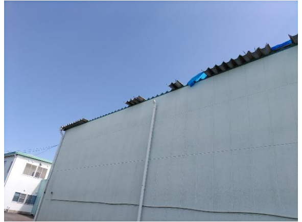
④屋根ふき材がはく離した倉庫 (南西方向から撮影)
