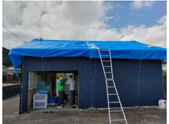
⑥屋根瓦が破損した木造非住家 (東方向から撮影)
