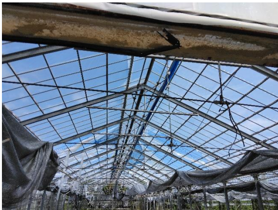
①農業用ハウスの損傷 （南方向から撮影）
