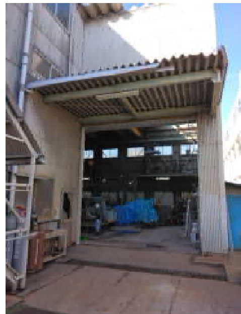
① 屋根が飛散した倉庫 (南西方向から撮影)
