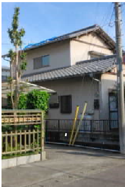
② 屋根瓦が破損した住家 (北西方向から撮影)
