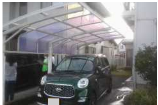
③ カーポートの破損 (東方向から撮影)
