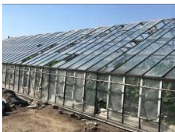
温室ガラスの破損（温室メロン）
