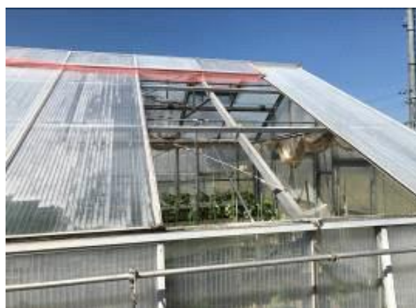
温室アクリル板の破損（温室メロン）
