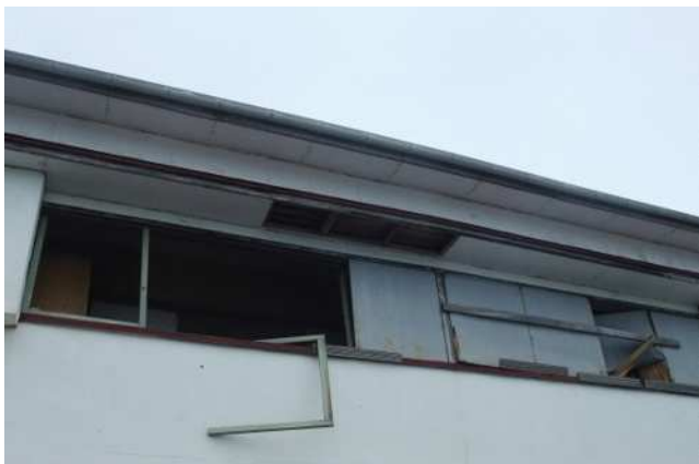
窓枠が破損した住家 (南伊豆町提供)
