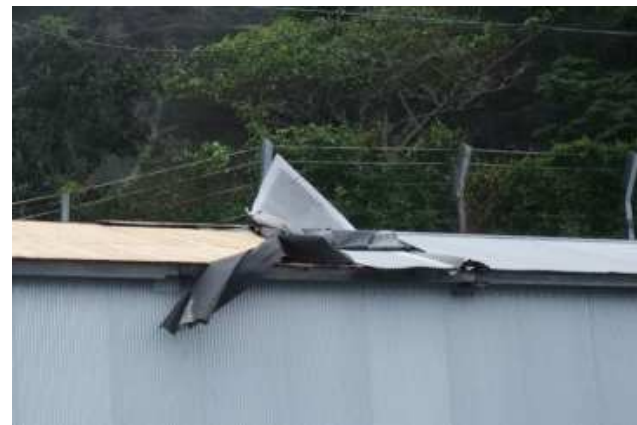
トタン屋根が破損した非住家 (南伊豆町提供)
