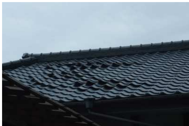
屋根瓦がめくれた住家 (南伊豆町提供)
