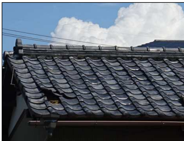
屋根瓦がめくれた住家 (南方向から撮影)
