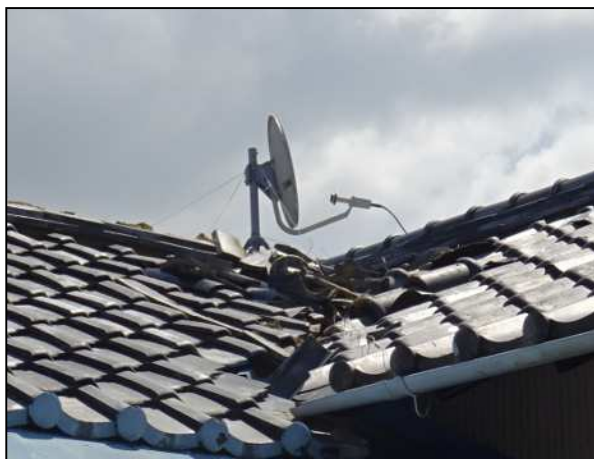
屋根瓦が落下した住家 (北西方向から撮影)
