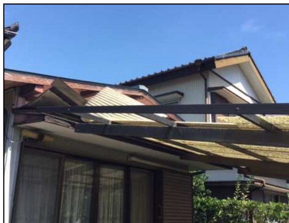
屋根の一部が破損したカーポート (南西方向から撮影)
