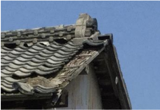
① 屋根瓦のめくれがあった非住家
