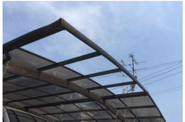
④ 屋根の一部が剥がれたカーポート
