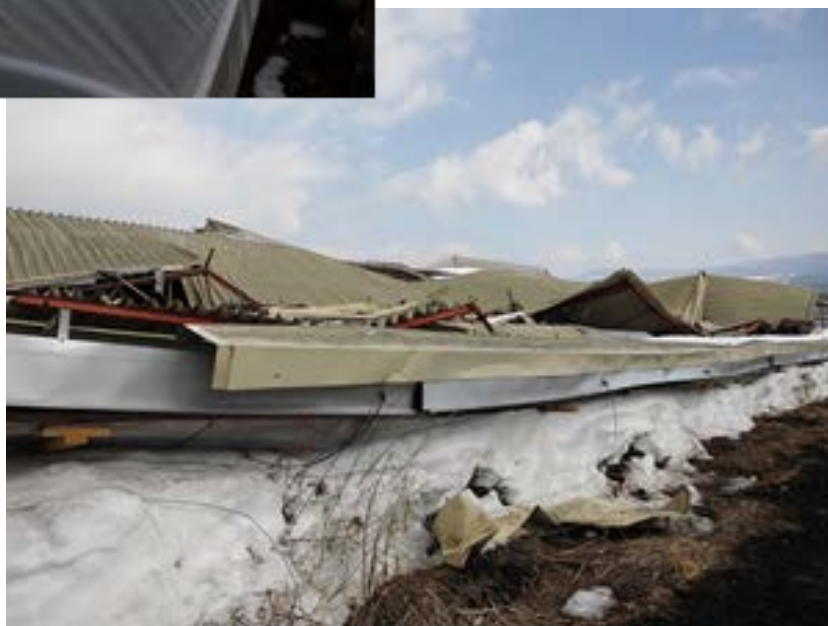
倒壊した畜舎
