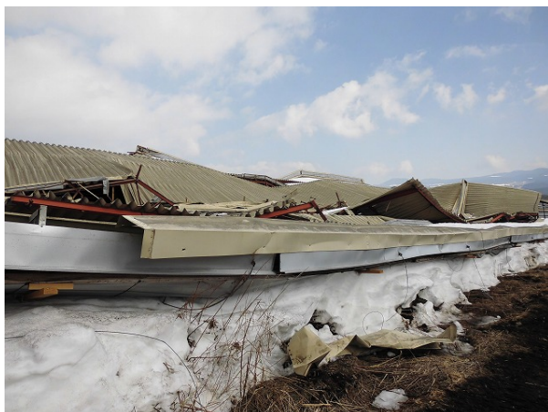
③倒壊した畜舎
