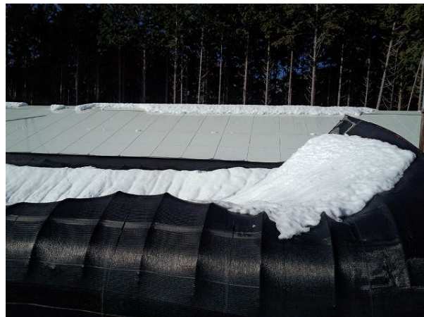
②倒壊したビニールハウス (しいたけ)
