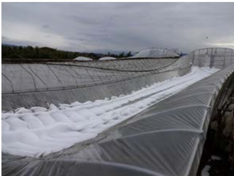
倒壊したビニールハウス
