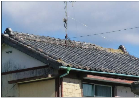
①棟瓦がめくれた住家（西南西から撮影）
