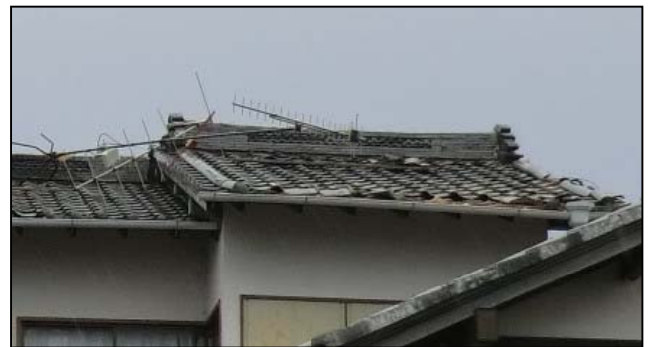
④アンテナが倒れ、屋根瓦がめくれた住家 （南から撮影）
