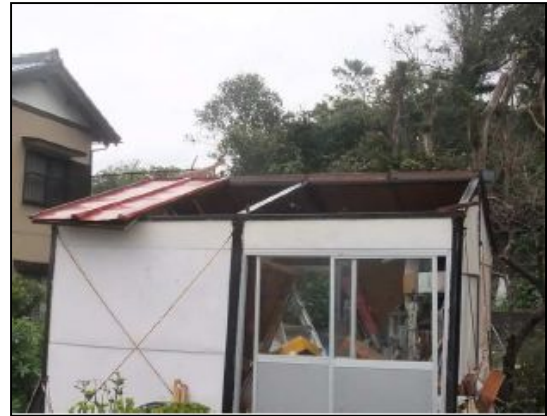
②トタン屋根の一部が飛散したプレハブ小屋 （南東から撮影）【袋井市提供】
