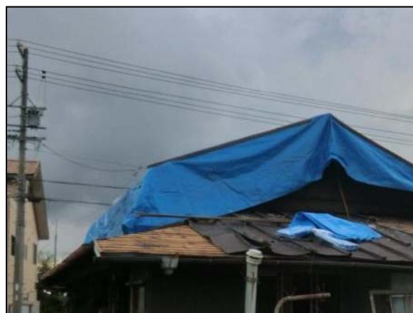
⑥ 屋根のトタンが剥がれた住家 (補修中) (東から撮影)
