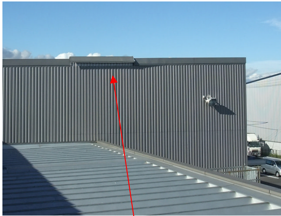
⑤ 屋根の一部破損
