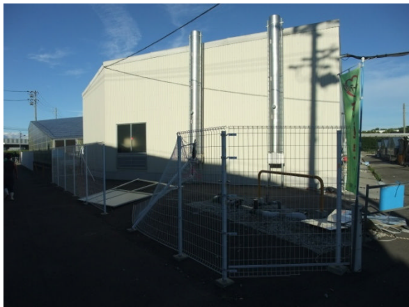
⑦ 破損したフェンス
