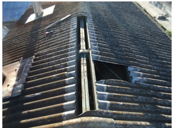
⑧ 破損したスレート屋根
