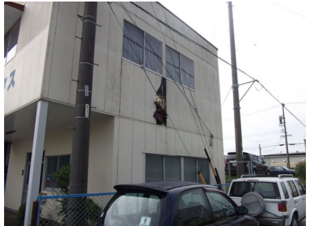
⑥ 外壁の一部破損
