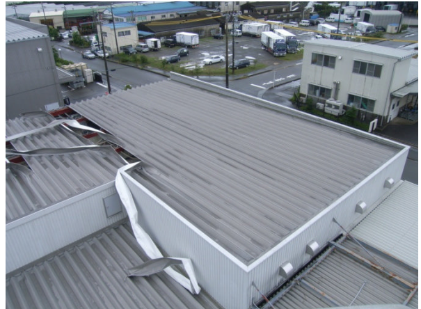
④ 屋根が剥離
