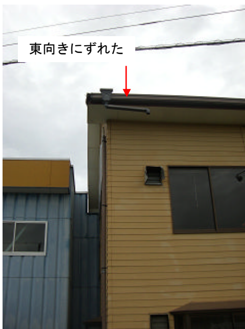
① 破損した雨どい
