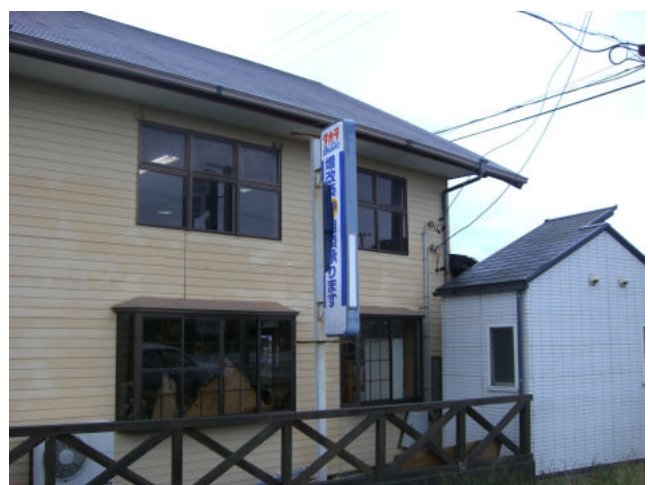
② 事務所看板の一部破損
