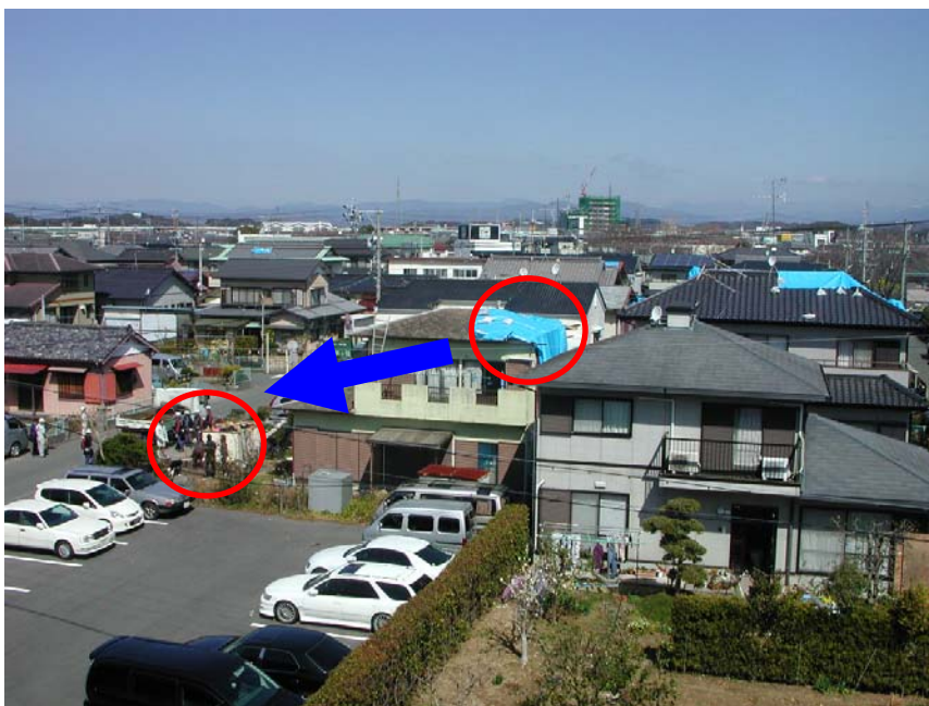
2. 西側へ飛んだ屋根
