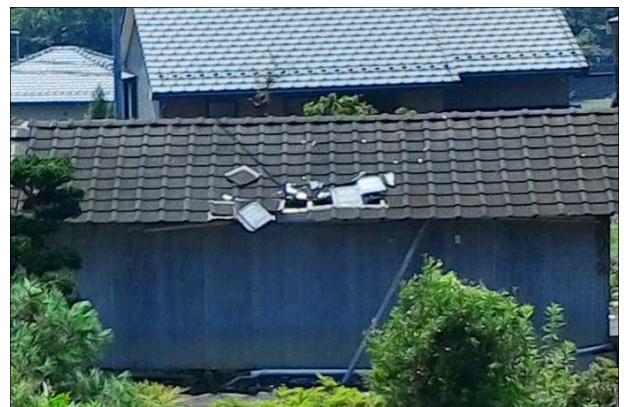
⑥ 屋根瓦のめくれた非住家 (北方向から撮影)
