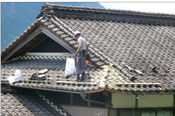
⑤ 屋根瓦のめくれた住家 (北西方向から撮影)
