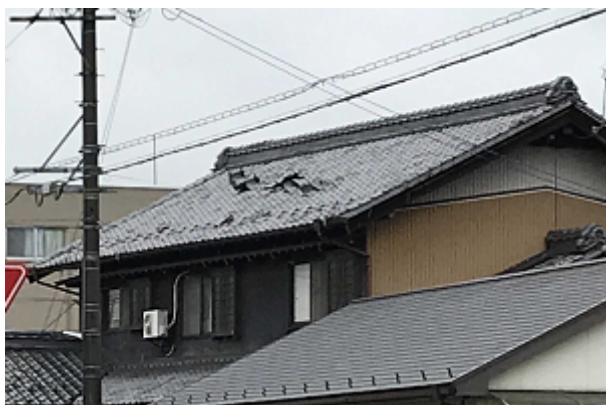
① 屋根瓦がめくれた住家 (北西方向から撮影)
