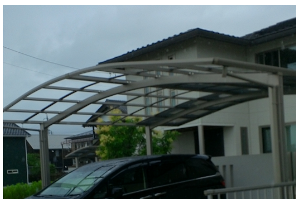
⑤ 飛散したカーポートの屋根パネル (南東方向から撮影)
