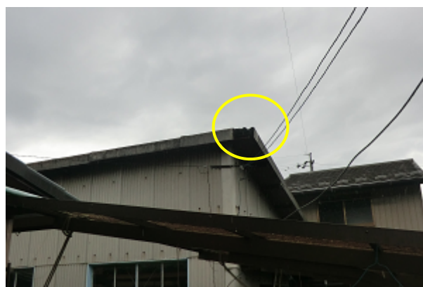
⑥ スレートが一部破損した非住家 (南方向から撮影)
