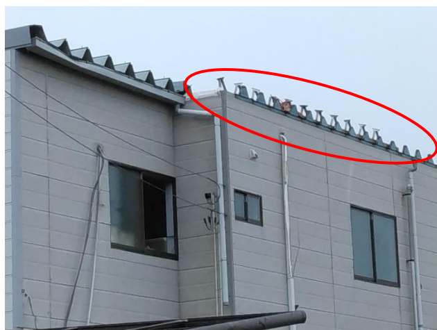
⑥屋根ふき材が剥離した事業所 (北西方向から撮影)
