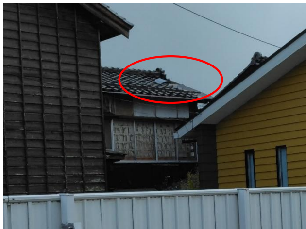
④屋根瓦が飛散した住家 (北東方向から撮影)
