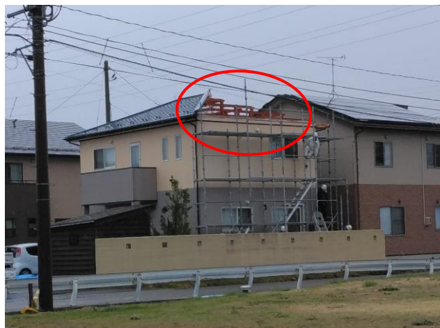
③野地板が飛散した住家 (南西方向から撮影)
