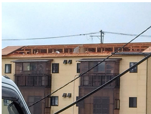
⑤小屋組が損壊した住家 (北東方向から撮影)
