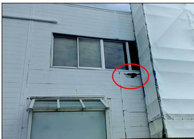
③ 外壁が破損した店舗 【北西方向から撮影】
