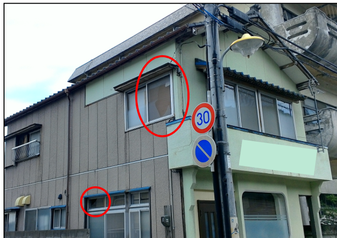
② 窓ガラスの破損があった住家 【南方向から撮影】
