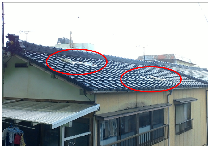
① 屋根瓦のめくれや落下があった住家 【南東方向から撮影】
