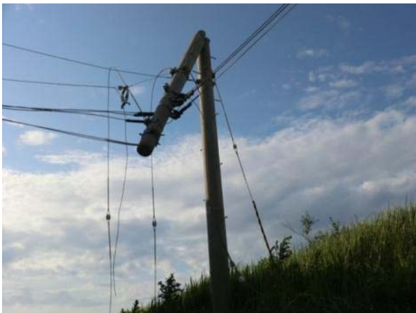
③西蒲区 折れたコンクリート製電柱 (南南東から撮影)
