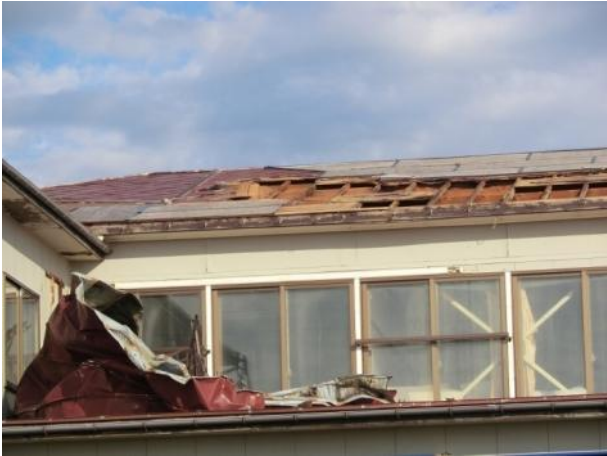
①西蒲区 屋根のトタンがめくれた住家 (北西から撮影)
