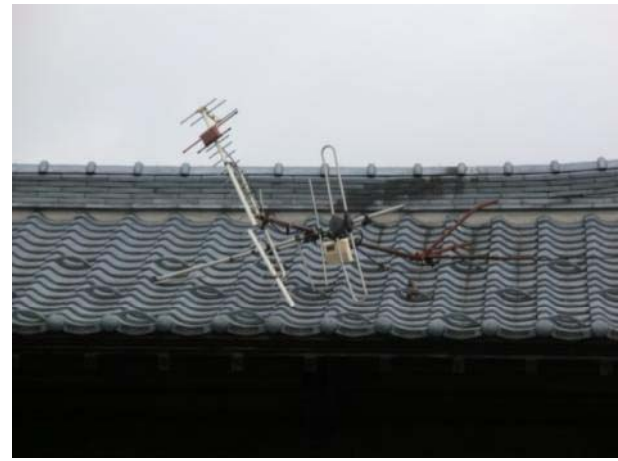
⑩五泉市 倒れたアンテナ（南南西から撮影）
