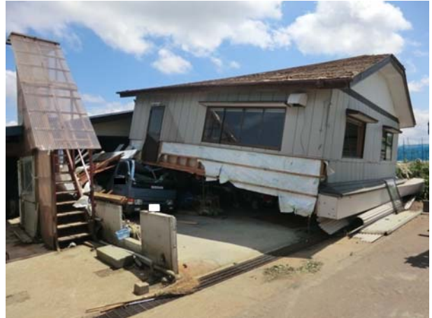
⑧南区 一階車庫部分が倒壊した非住家 （北西から撮影）
