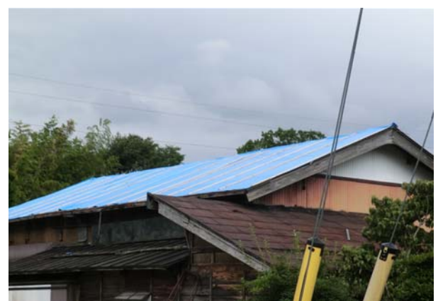
⑫五泉市 屋根のトタンが剥がれた住家（補修中） （西から撮影）
