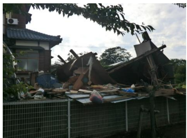
⑥西区 倒壊した倉庫 (東南東から撮影)
