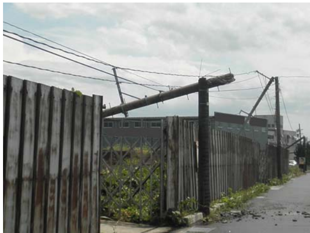
⑨南区 折れたコンクリート製電柱 （北から撮影） 南区役所提供
