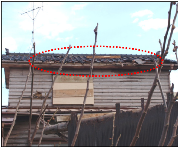
①屋根瓦のめくれや落下 (西から撮影)
