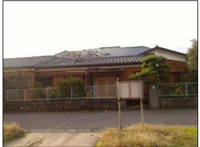
②剥離した屋根瓦 (北から撮影)
