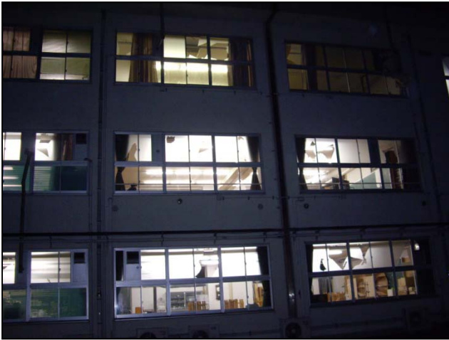
①割れたガラス (南東から撮影)
