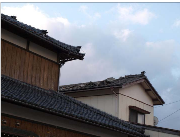
⑤剥離した瓦屋根 (北から撮影)
