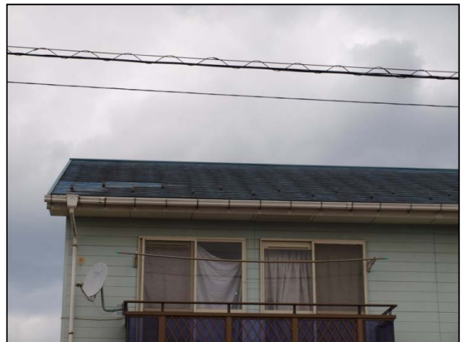
⑥剥離した屋根 (南から撮影)
