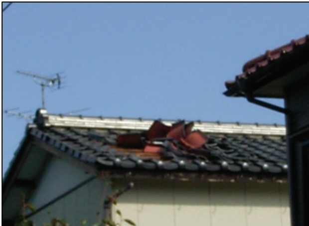
③ はく離した屋根瓦 (南西から撮影)
