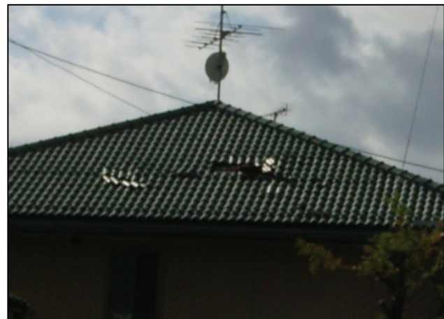
⑥ はく離した屋根瓦 (東から撮影)
