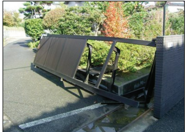
④ 破損した門扉 (南西から撮影)
