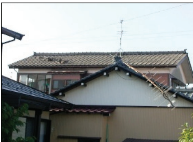
⑤ アンテナの倒壊、はく離した屋根瓦 (北東から撮影)
