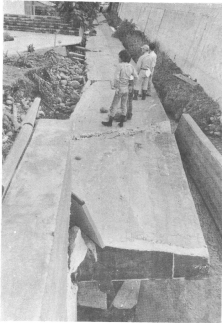
海川河口コンクリート堤防崩れる。この付近で行方不明2名でる。
