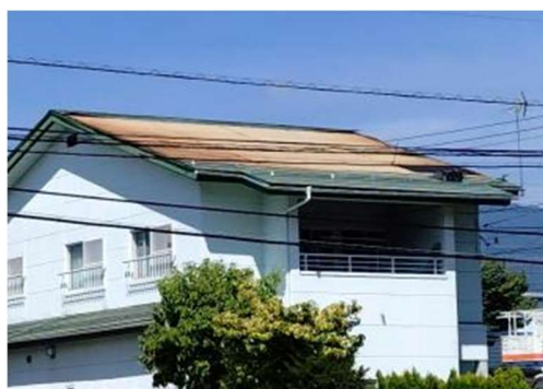
②国分 屋根が剥がれた住家
