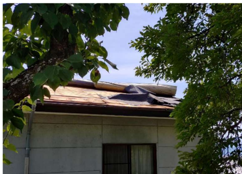
①住吉 屋根が剥がれた住家
