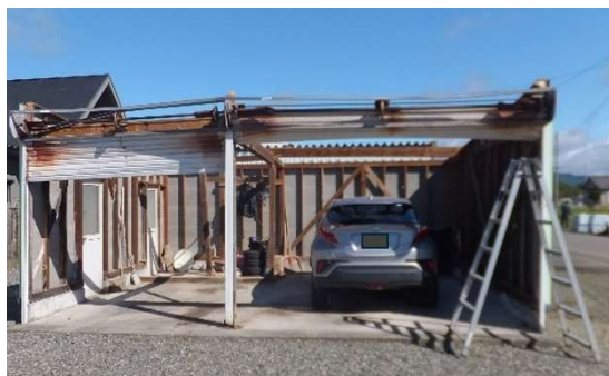
④ 屋根が飛散した車庫（本桐）
