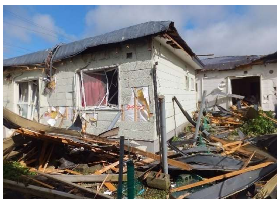
⑤ 飛散物により破損した住家（本桐）
