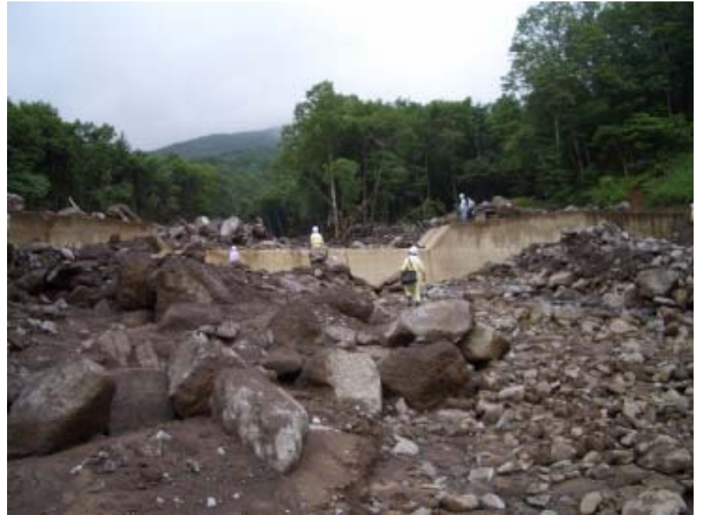
土砂で一杯になった御神坂沢砂防ダム
