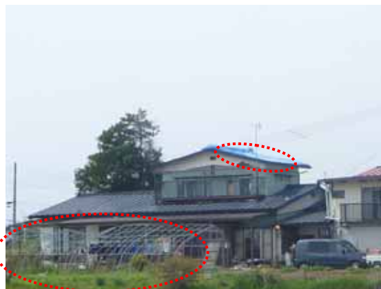
写真3 A-1: 剥離した屋根の部分 A-3: 損壊したビニールハウス
