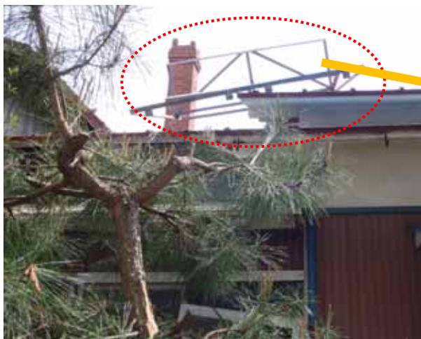
写真6 C：ソーラー温水器の架台のはずれ
