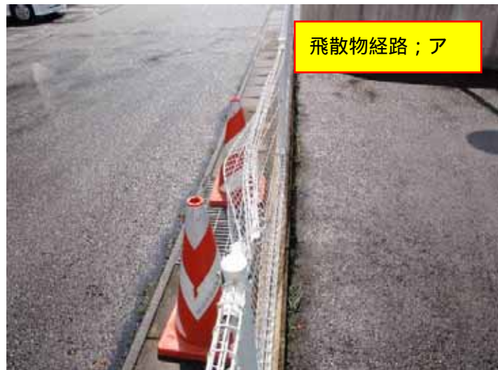
写真 B 飛散物によって破損した県営青山アパートフェンス（東 西方向を撮影）
