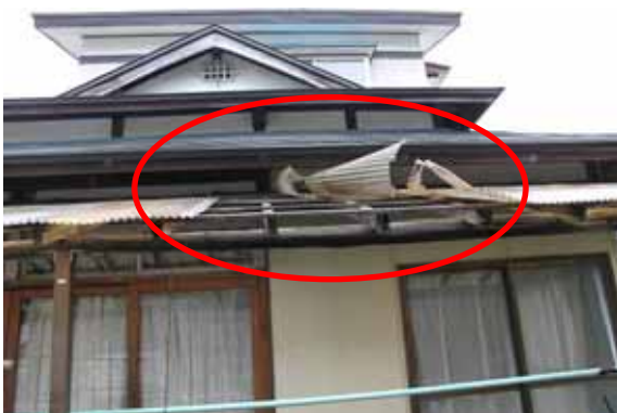
写真 P 聞き取り調査 の住宅南側のひさしの 一部破損（写真提供；盛岡西消防署）
