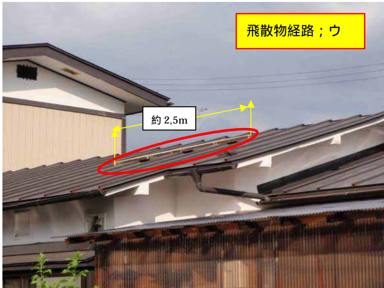
写真 D 屋根に角材が飛んで来た。形状から、飛散物は南西方向に直線距離で約 50m 離れた場所で被災した何れかの住宅の、ひさしの一部と思われる
