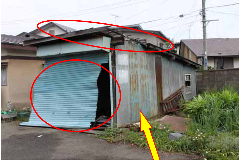
写真 N 物置小屋の屋根及び出入口 シャッター破損（写真提供；盛岡西消防署） 屋根の飛散先は不明
