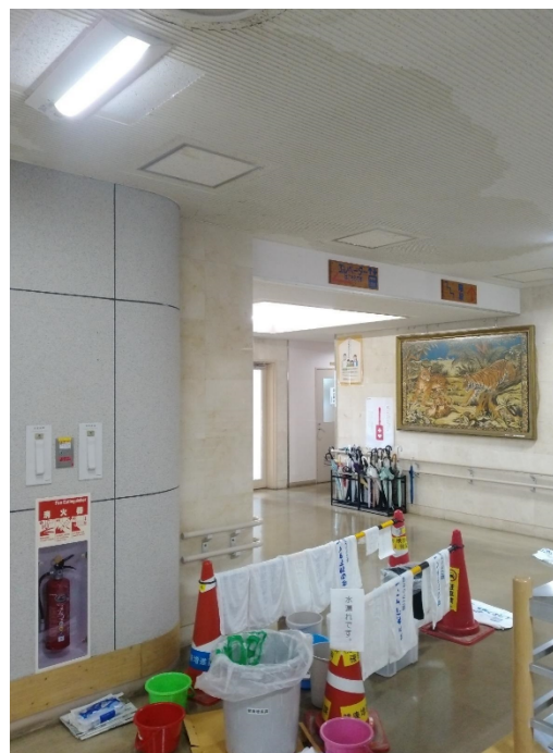
写真4 天井から水漏れ (日南市中央通)
