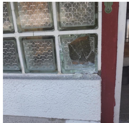
写真2 店舗のガラス破損 (日南市南郷町)
