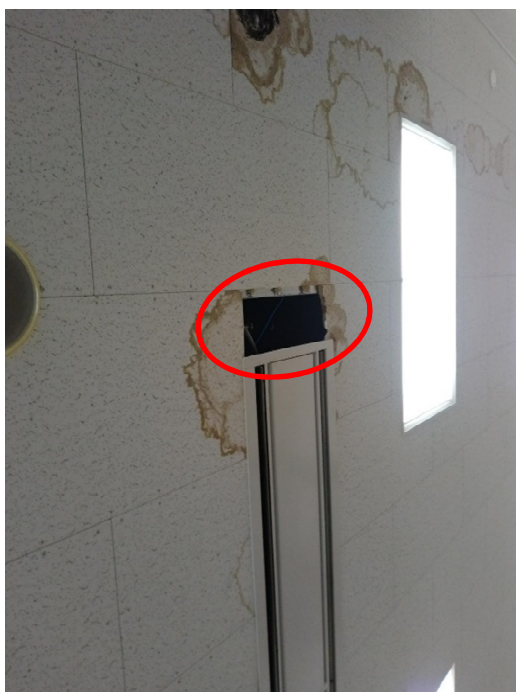
写真3 天井石膏ボード損傷 (日南市中央通)
