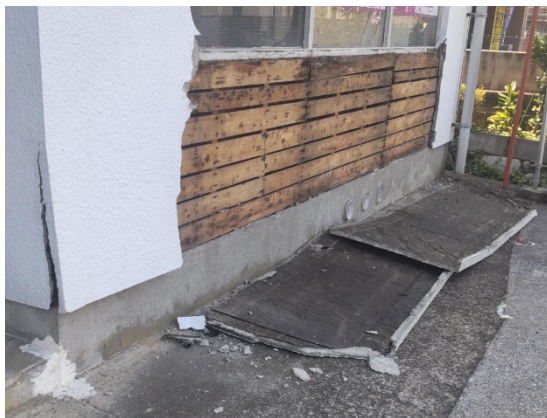
写真1 店舗の壁面剥離 (日南市南郷町)
