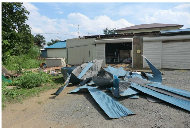
⑨ 非住家の屋根のトタンの飛散 (南東方向から撮影)
