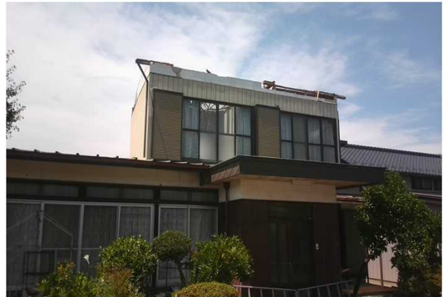
④ 屋根が飛散した住家 (南東方向から撮影)
