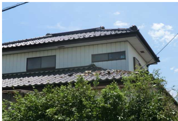
⑧ 住家の屋根瓦のめくれ (北東方向から撮影)
