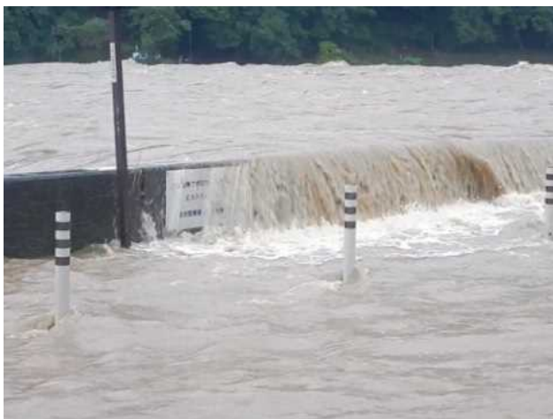
提供：国土交通省近畿地方整備局 京都府京都市右京区嵐山（桂川）
