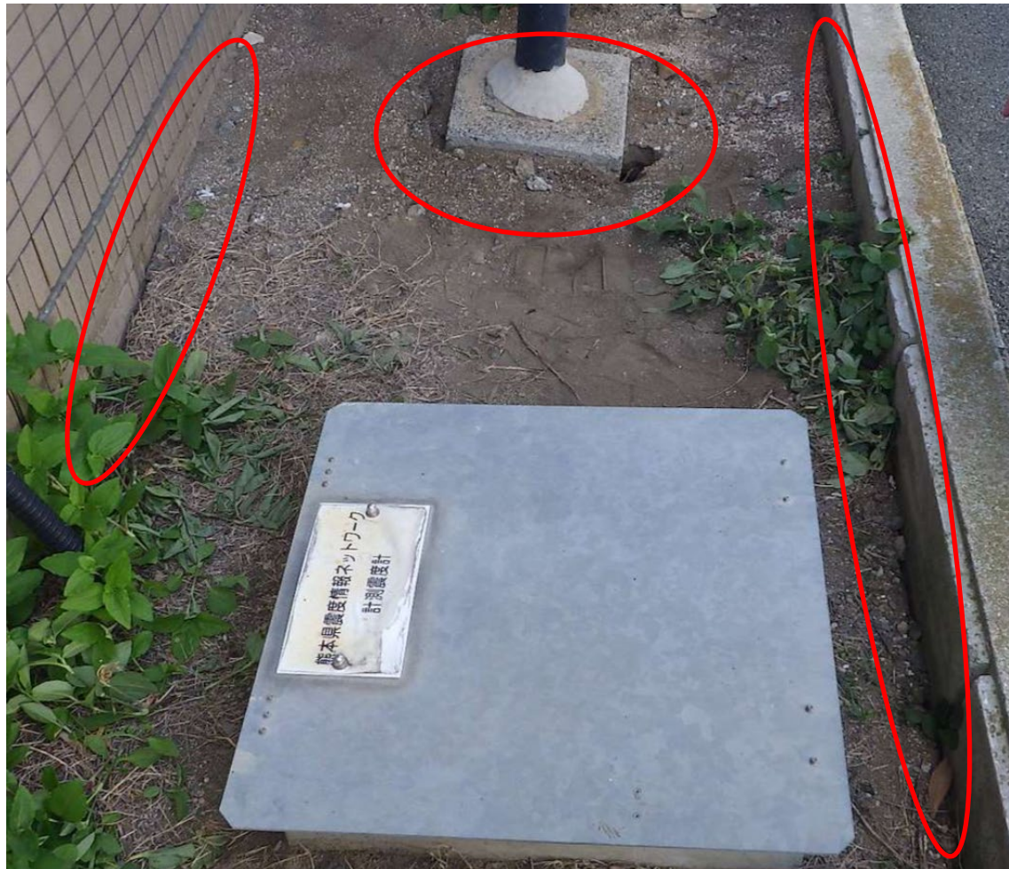
周辺地盤のひび割れ
