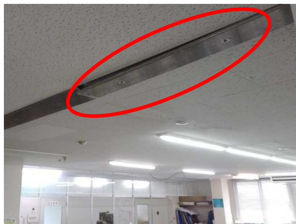
写真 2 天井の金属製パネルの剥離
