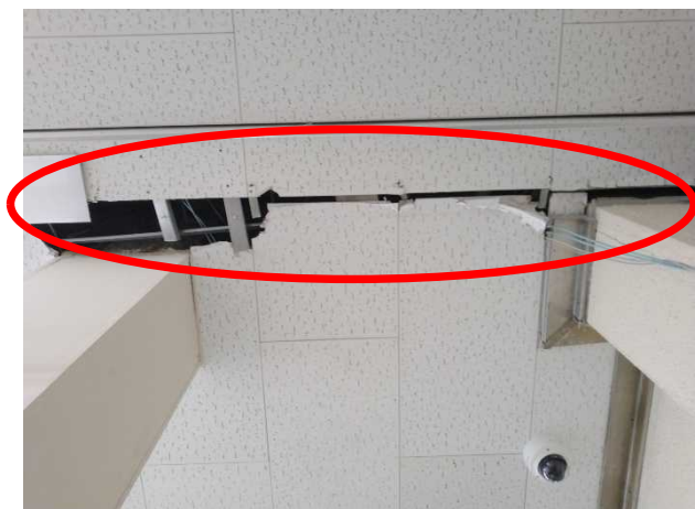
写真 1 天井石膏ボードの損傷
