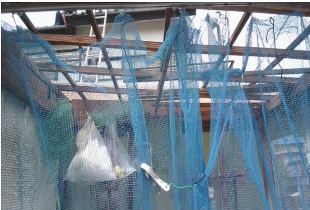
③ 屋根が飛散したゴミステーション (南方向から撮影)
