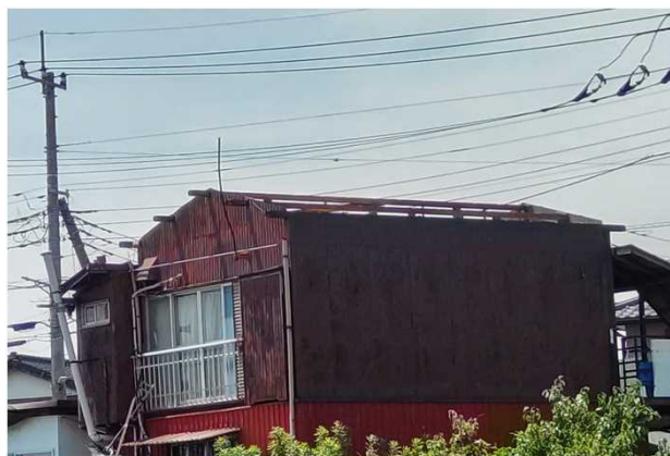
⑩ 屋根が飛散した住家 (南方向から撮影)
