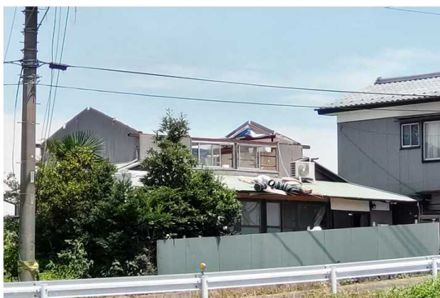
⑪ 屋根が飛散した住家 (南方向から撮影)
