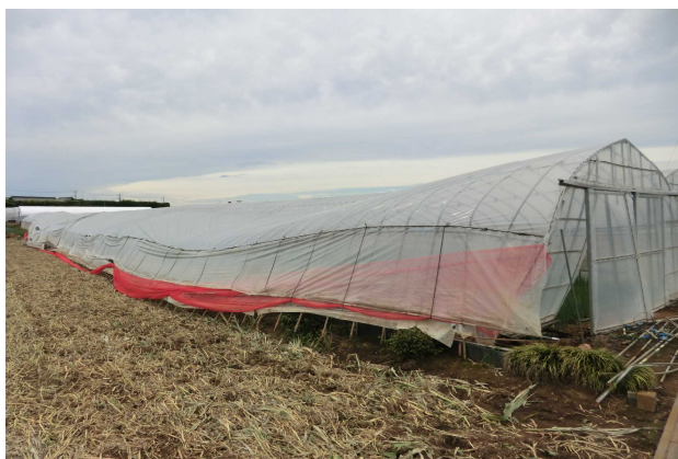
⑮ 農業用ビニールハウスの変形 (南東方向から撮影)
