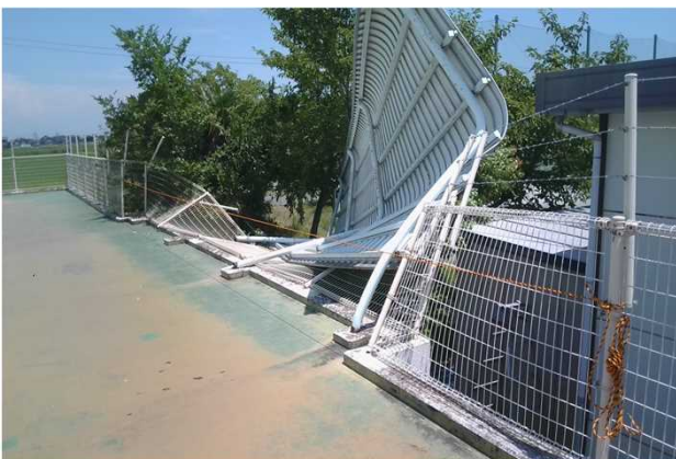
⑤ 支柱が倒れ破損した日よけ (南西方向から撮影)
