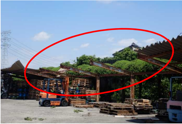
① 屋根の構成部材が飛散した非住家施設 (南方向から撮影)
