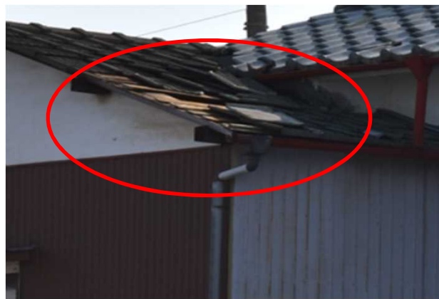
② 屋根瓦がめくれた住家 （北東方向から撮影）
