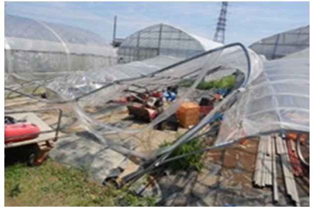
④ 鋼管が変形したパイプハウス (北方向から撮影)
