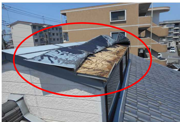
① トタン屋根がめくれた非住家 （熊谷市営繕課提供） （東方向から撮影）
