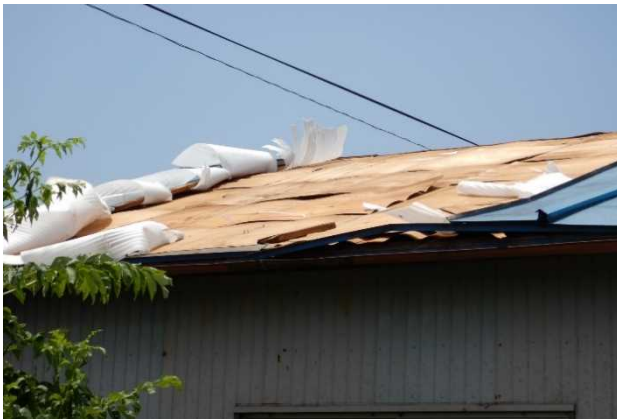
③ 屋根の構成部材が破損した非住家 (西方向から撮影)
