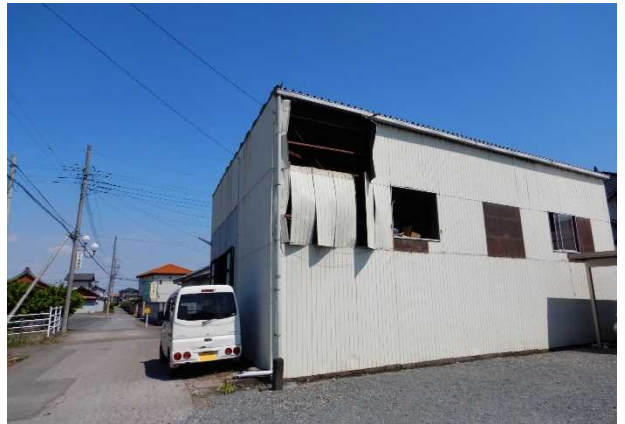
② トタンがはがれた倉庫 (西方向から撮影)
