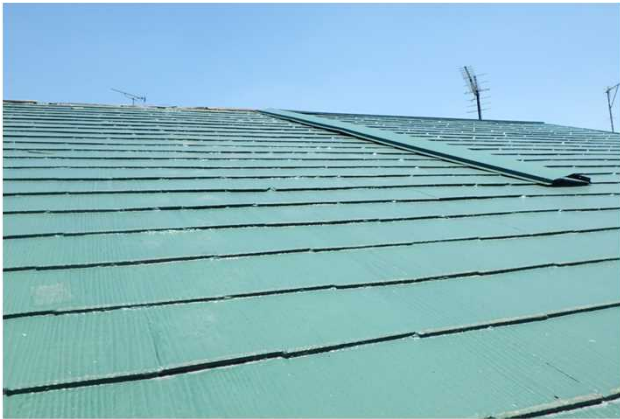
① 屋根の天板がずれた住家 (玉村町提供) (東方向から撮影)
