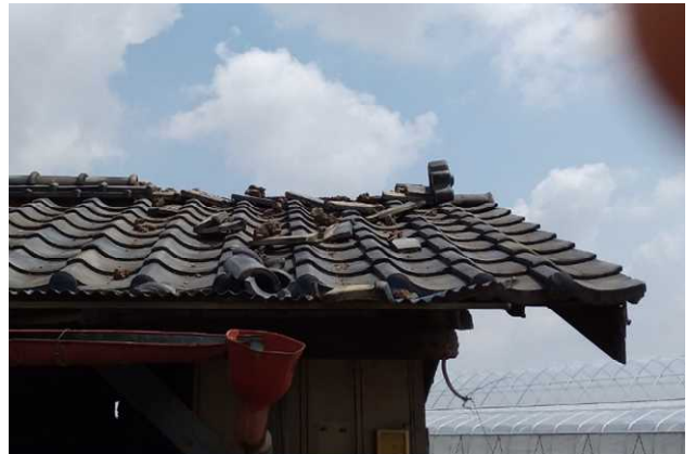
② 屋根瓦がめくれた住家（玉村町提供） (南方向から撮影)
