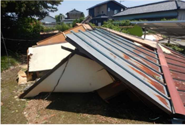
① 倒壊した物置小屋 (北西方向から撮影)
