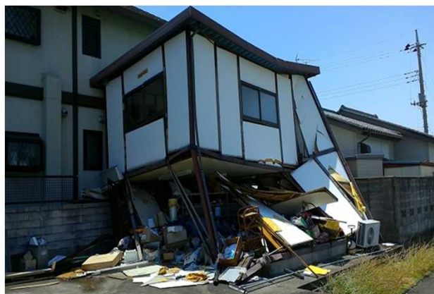
⑤ 倒壊した物置小屋 (北東方向から撮影)
