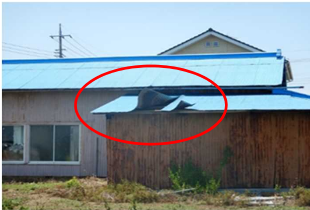
③ トタン屋根の一部がめくれた非住家 (東方向から撮影)
