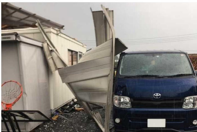
③ はく離、飛散したシャッター式車庫 (玉村町提供) (東方向から撮影)
