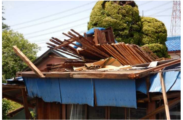
② 屋根の構成部材が破損した非住家 (南方向から撮影)
