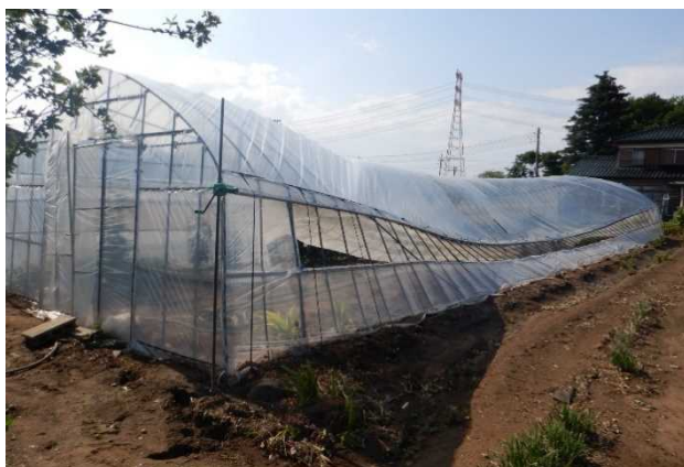
⑤ 鋼管が変形したパイプハウス (南東方向から撮影)
