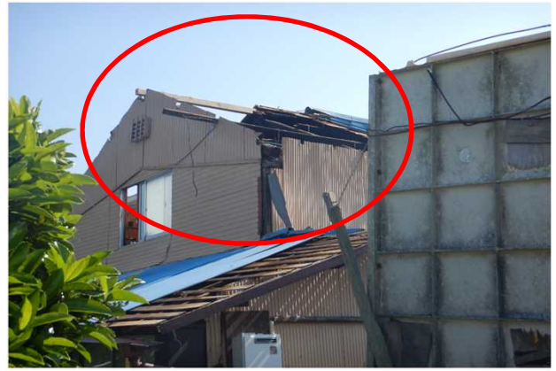
④ 屋根が飛散した住家 (南方向から撮影)
