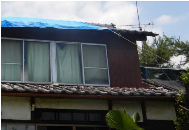
③ 屋根瓦が飛散した住家 (南西方向から撮影)
