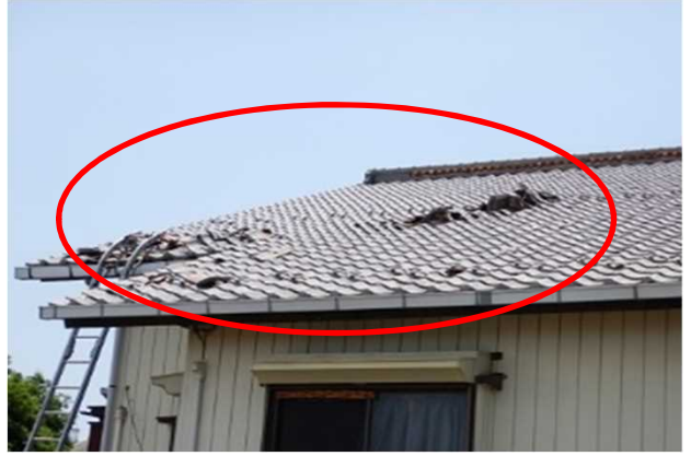
② 屋根瓦がめくれた住家 (北方向から撮影)
