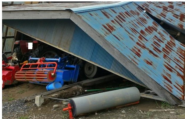
③ 車庫の倒壊 (東方向から撮影) 「提供：伊勢崎市役所」
