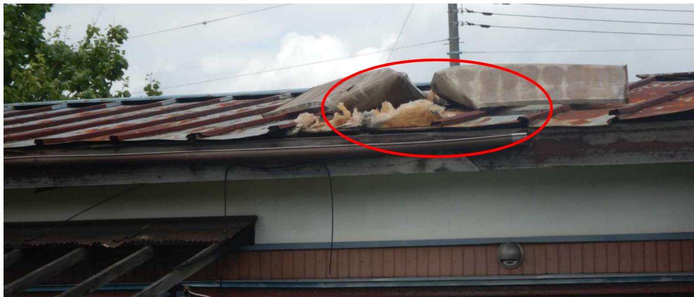
① 屋根の一部がめくれた住家（南南東方向から撮影）
