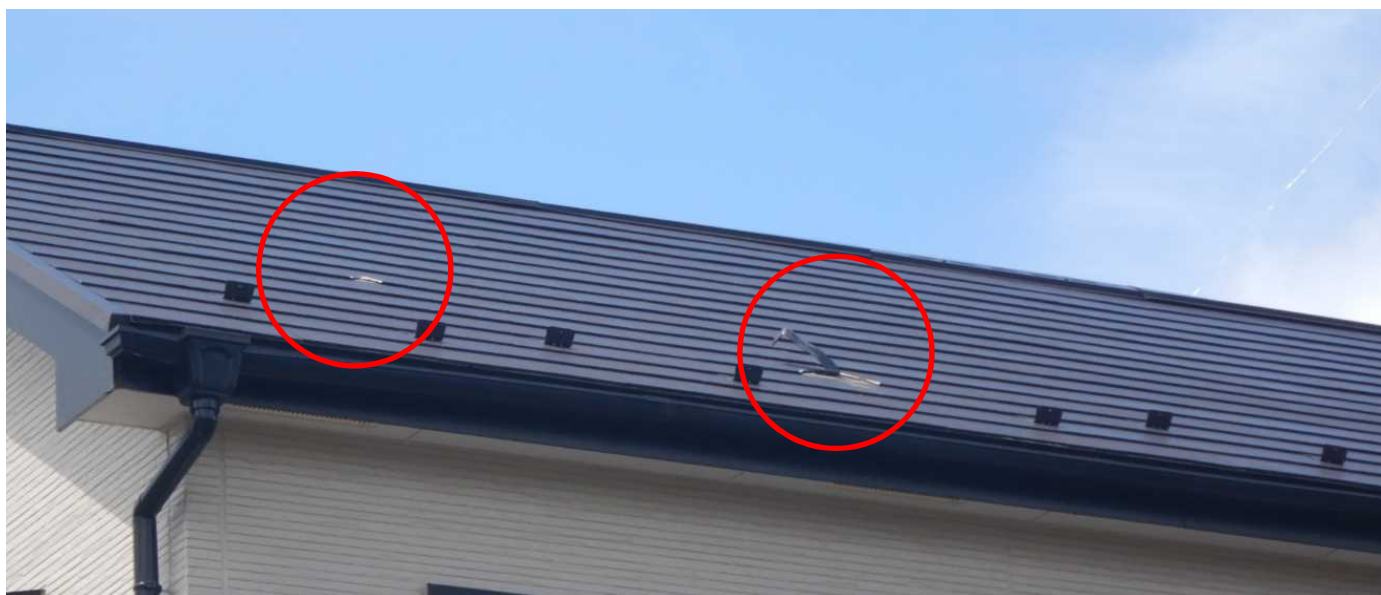
② 屋根の一部がめくれた住家（南方向から撮影）
