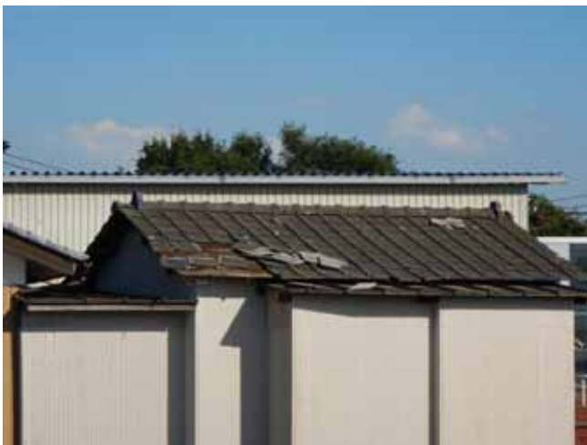
屋根瓦がめくれた住家（荒木） （北西方向から撮影）
