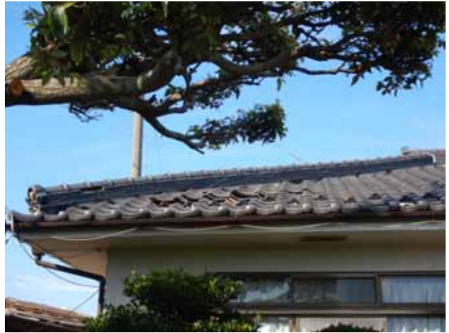
屋根瓦がめくれた住家（荒木） （南西方向から撮影）
