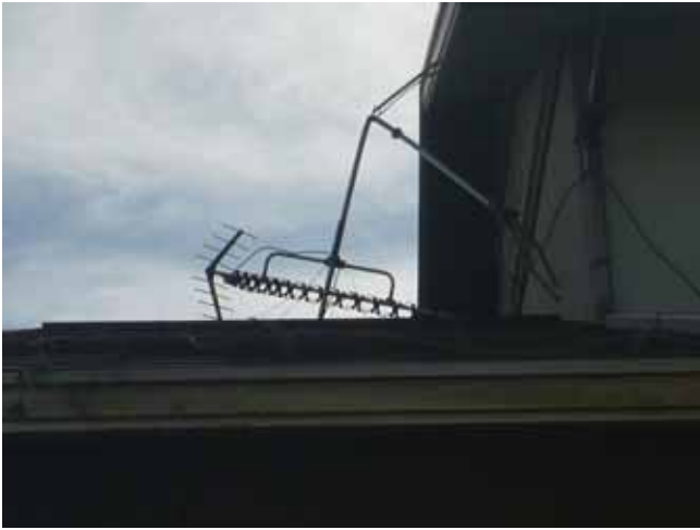
倒れたアンテナ（荒木） （北東方向から撮影）
