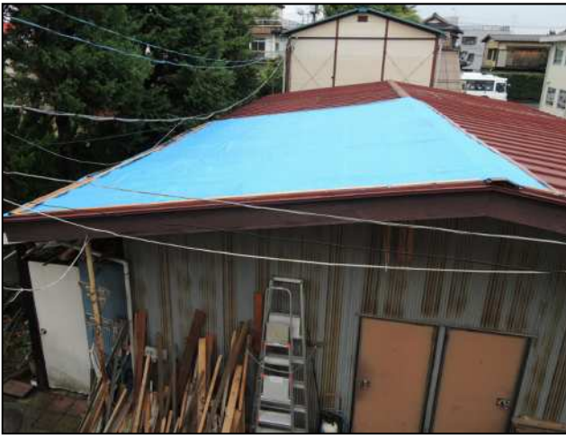
屋根が飛散した倉庫（新座市） （南西から撮影）
