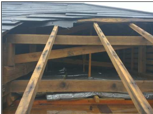
屋根の野地板が飛散した住家 (北東から撮影)
