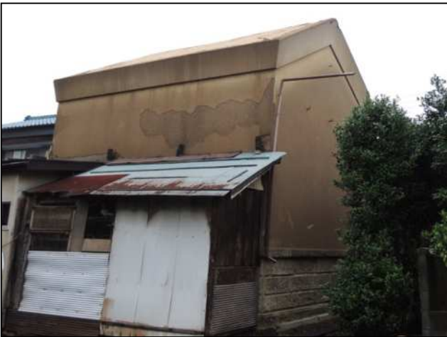
屋根が飛散した土蔵（新座市） （南東から撮影）
