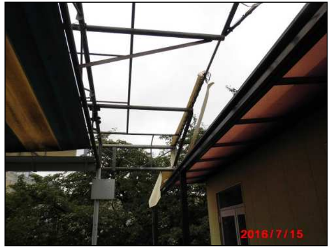
ビニール製の屋根がめくれたテラス （新座市）（北西から撮影）
