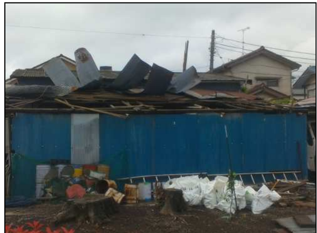
トタン屋根がめくれた非住家（新座市） （北西から撮影）
