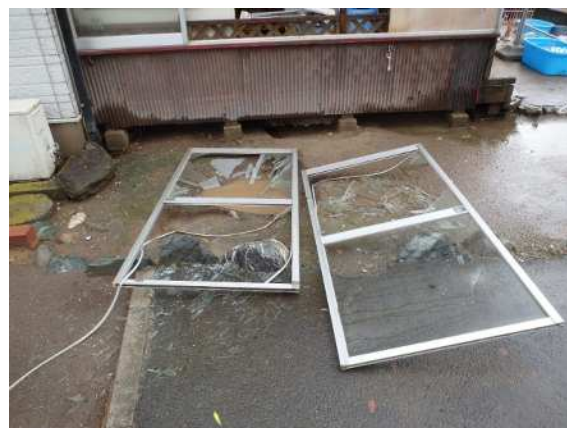
住家から外れたアルミサッシ (南西から撮影) 越谷市役所提供
