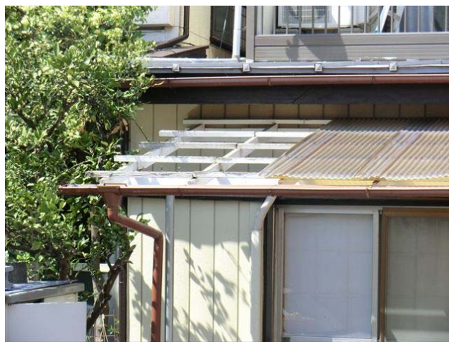
⑩住家トタン屋根破損 (南から撮影)
