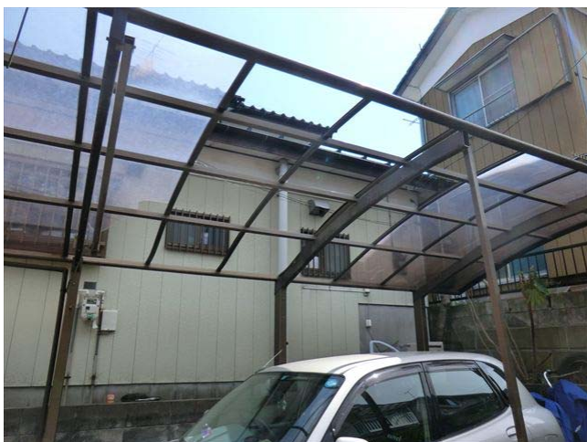
⑨車庫の屋根破損、飛散 (東から撮影)
