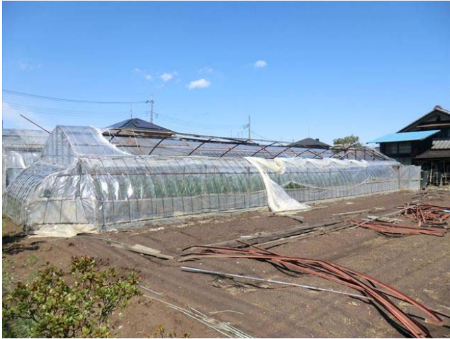
①ビニールハウスのビニール破損 (東から撮影)
