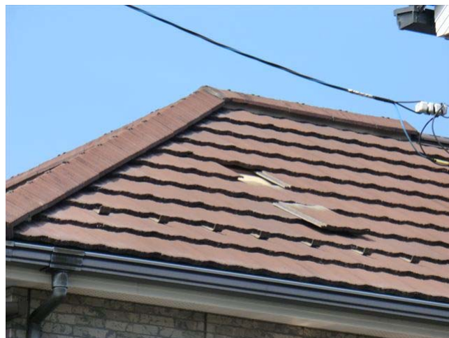
⑧住家屋根瓦のめくれ (南西から撮影)
