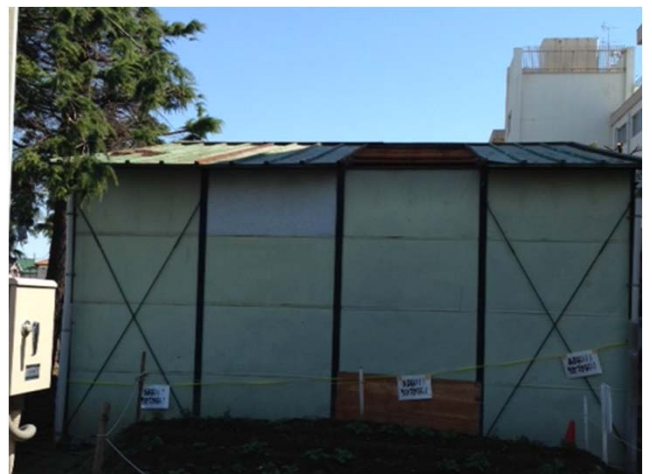
⑥小学校の倉庫の屋根飛散 (西から撮影)
