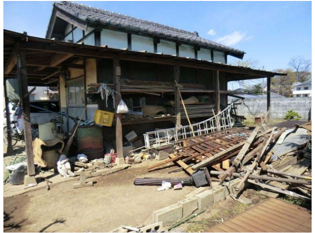
②倉庫トタン屋根の倒壊、飛散 (南東から撮影)
