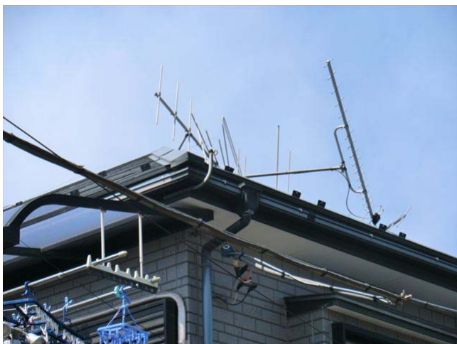
⑦住家屋根のアンテナ北東へ倒れる (南東から撮影)
