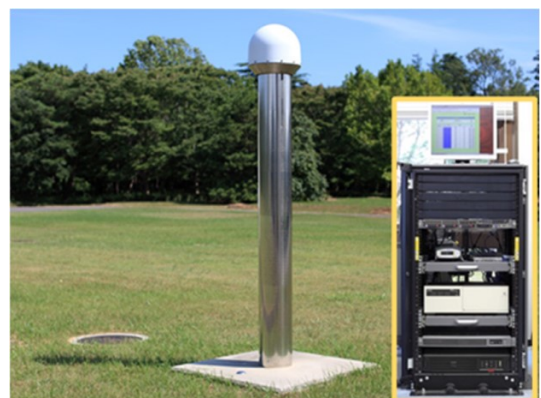
図 3.6.4 GPS 気柱水蒸気量観測設備
