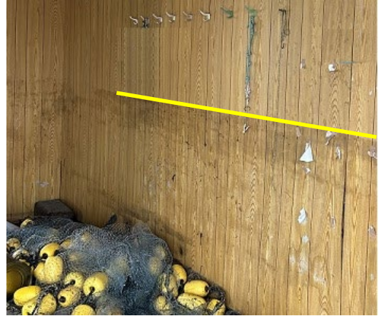
写真8-14：津波の痕跡（珠洲市鵜飼漁港）
