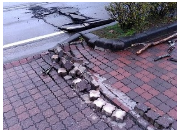
写真8-4：道路の亀裂及び段差
