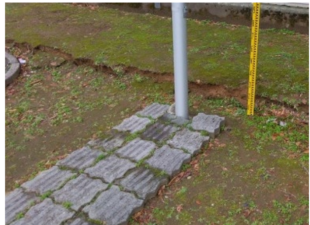
写真8－10：地面のひび割れ及び段差
