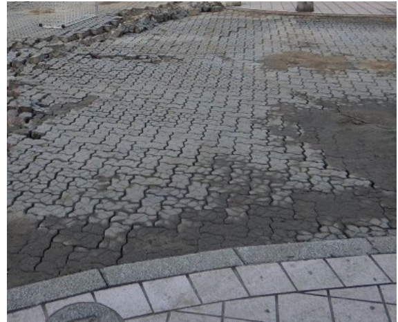
写真8－12：道路の亀裂及び液状化
