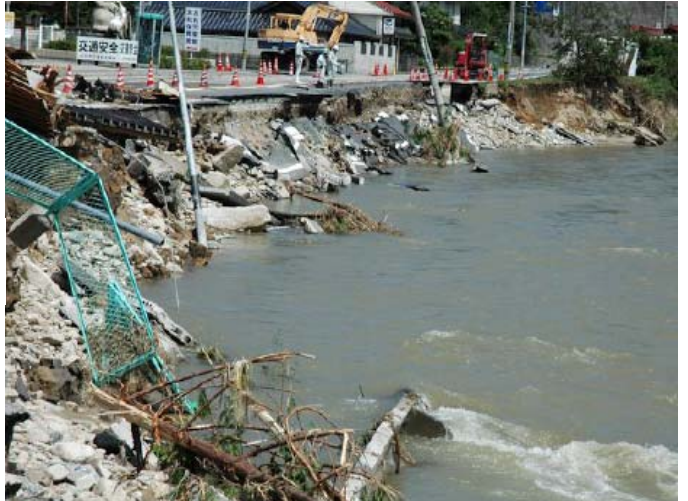
⑤ 崩壊場所の最下流側から上流側を望む
