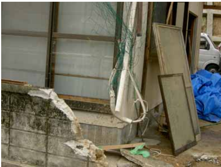
土砂流入により民家のブロック塀(約1m)を破壊。
