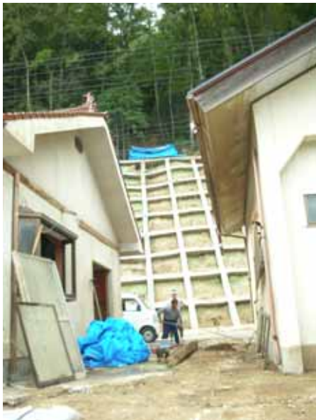
民家(左)と集会所(右)を土砂が直撃。また、この間を土砂が駆け抜け、国道433号まで流出。
