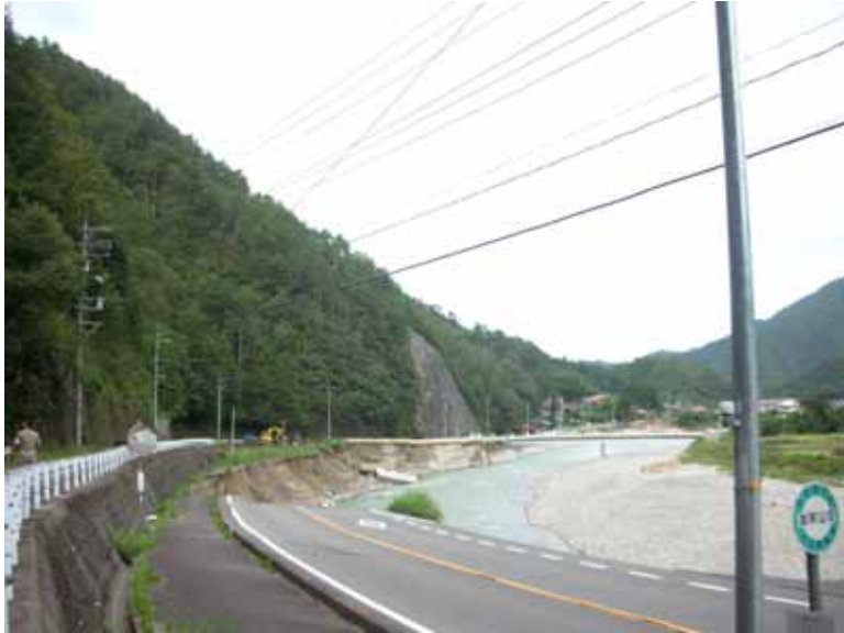
水内川の増水により国道433号の崩落（湯来出張所側から撮影）。ガードレールより左側は、旧道。 【長さ約200m×幅約12m】
