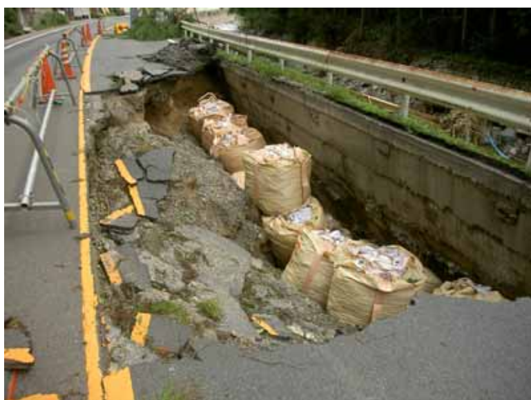
国道433号の崩落 (伏谷川下流から撮影)
