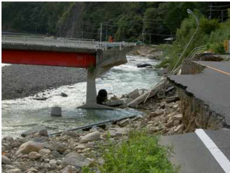
水内川に架かる橋の流失（右側に国道433号のセンターライン）。
