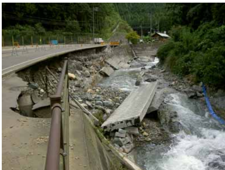
国道433号の崩落 (伏谷川上流から撮影)
