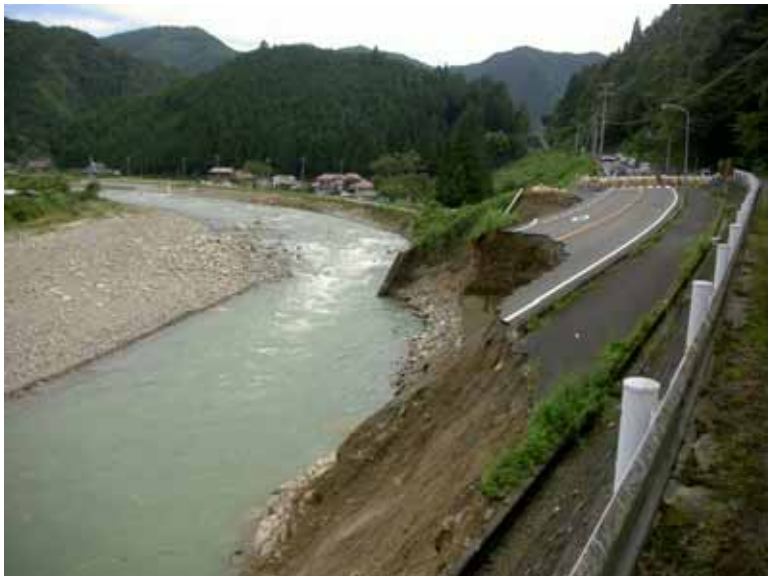
水内川の増水により国道433号の崩落（旧道より撮影）。国道の側溝しか残っていない。奥に見える住家の浸水はない。
