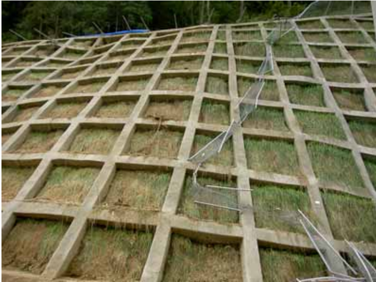
上麦谷集会所裏の法面 (約15m斜面の上に張られていた土石落下フェンスを突破して土砂が流出)
