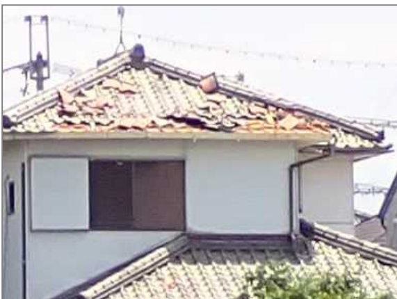
写真⑤ 屋根瓦がめくれた住家 (東に向かって撮影)
