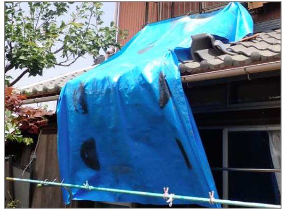
写真② 屋根瓦がめくれた住家 (北西に向かって撮影)
