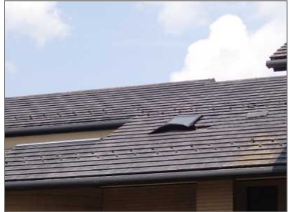
写真④ 屋根瓦がめくれた住家 (北東に向かって撮影)
