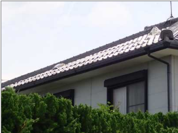
写真③ 屋根瓦がめくれた住家 (東に向かって撮影)
