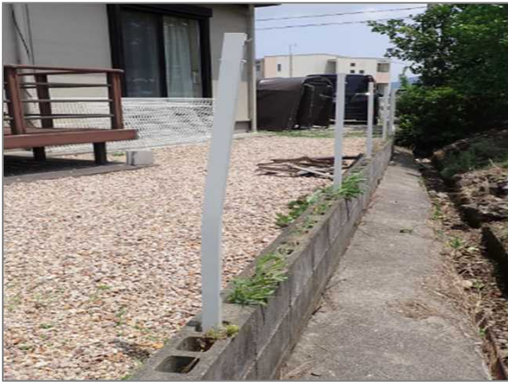
写真① フェンスの一部損壊 (南東に向かって撮影)
