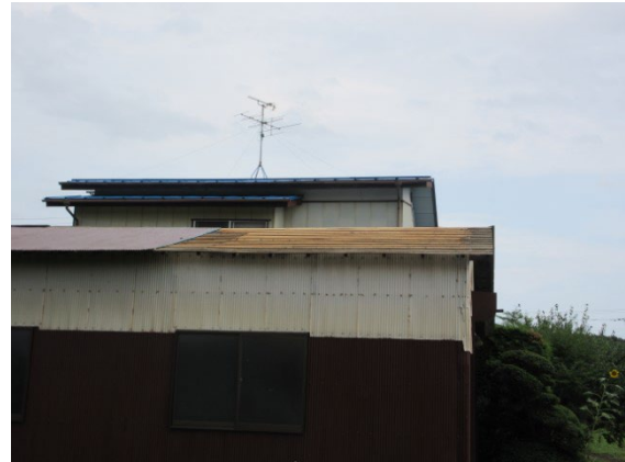
②作業小屋の屋根破損
