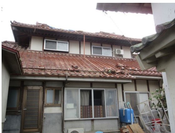
③住宅の屋根瓦破損
